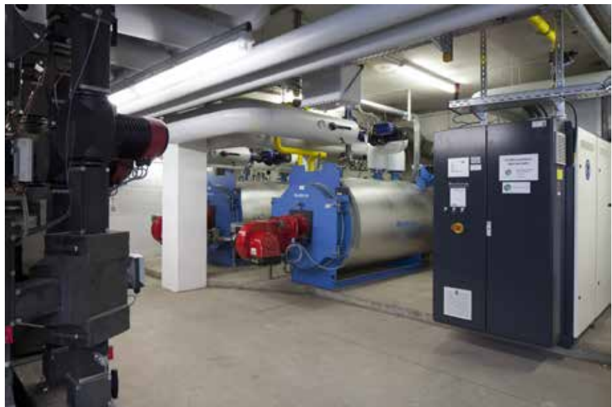
Abbildung 2: Zwei Buderus Niedertemperaturkessel (links) unterstützen das BHKW (rechts) in Spitzenlastzeiten bei der Warmwasserbereitung. Bild: Felix Krumbholz
